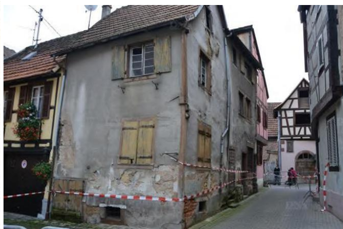
Située au centre de Bouxwiller, la maison (ici au centre) menace de s'écrouler. Photos DNA – Guillaume Erckert
